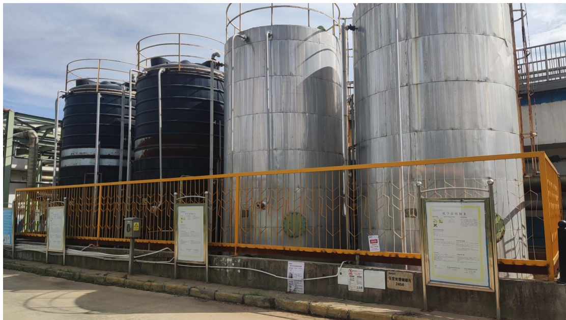
图 8.5.4-1 装置区、罐区围堰及其配套设施设置情况
